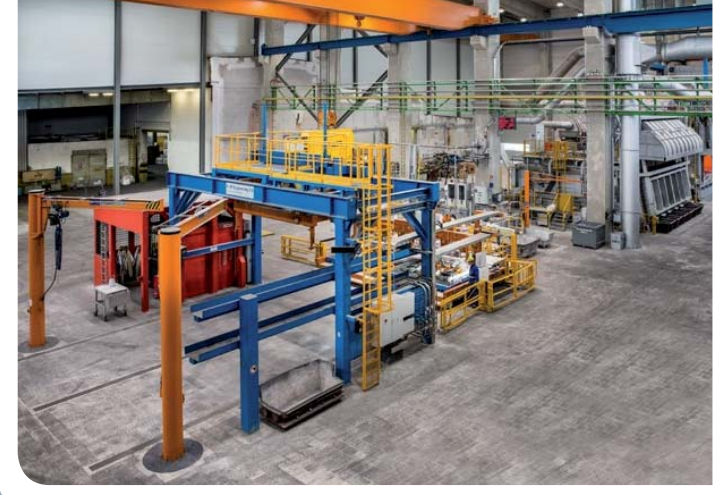
Abb 1: Die neue Walzbarrengießanlage mit Schmelz- und Gießöfen im Hintergrund
