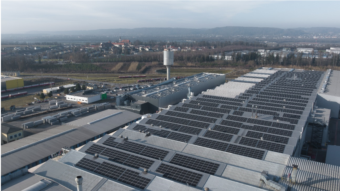
PV-Anlage auf den Hallendächern der AMAG (©AMAG)
